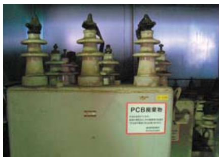
新川工場PCB廃棄物保管状況
