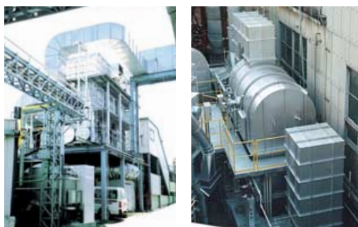
排ガス燃焼処理装置
